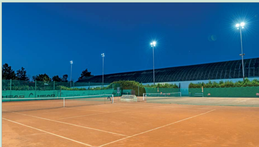
Energiesparendes und umweltschonendes Flutlicht im LZ Südstadt.
