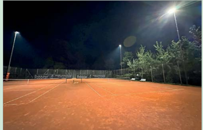
Erneuertes Flutlicht beim SV Finanz Salzburg. © bi-LED
